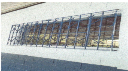
Foto 5: VISTA DE VENTANAS CON SUS BALCONES PINTADOS.
